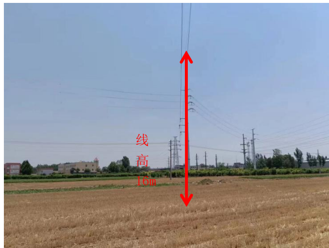
图 7-12 110kV 津箭宋线 T 宋楼站支线 4#-5#线下
