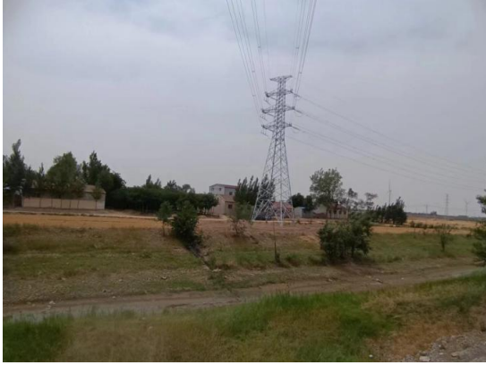
图6-1 塔基“一档跨越”生态红线照片 (110kV 津砚盟线40-41#/110kV 津历鸿 线45-46#)
