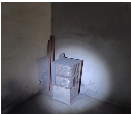
曝光室内西北侧通风设施
